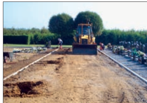
Een vernieuwing van de kerkhofpaden was nodig omdat de oude omhoog gewerkt waren door de bomen.
